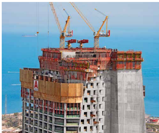
An den Außenfassaden des 412 Meter hohen Al Hamra Towers in Kuwait sorgten PERI-Systeme für den Schutz bei der Herstellung von Geschossdecken.
